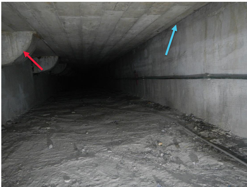
Foto 7.1.9 – Ventilationskanal med udsugningskanaler i venstre side (rød pil), og indblæsningsspalte mellem ydervægsgfundament og kantbjælke i dækkonstruktion (blå pil).
