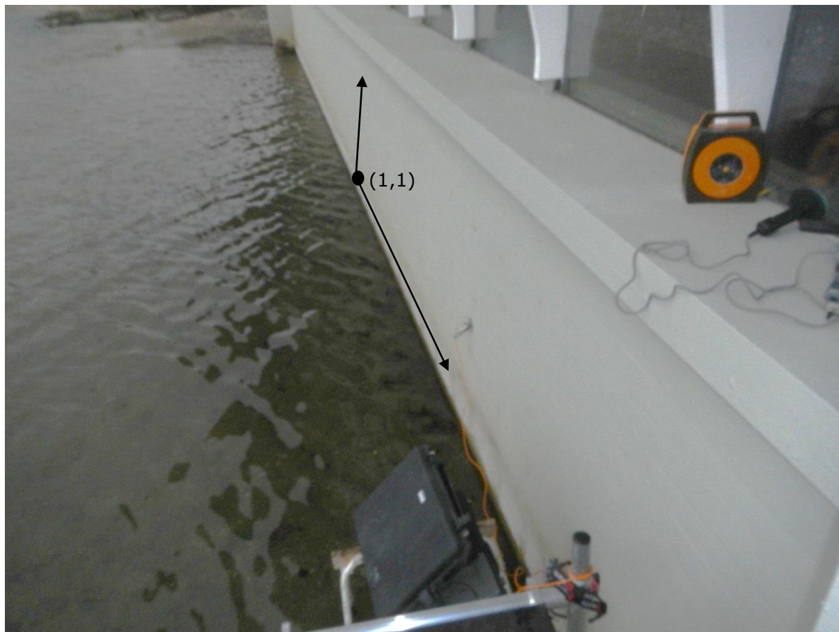
Figur 7.4.7. Placering af EKP-målefelt på facadebjælke F2. Målefeltet består af i alt 16 målepunkter i x-retningen (vandret) og 5 målepunkter i y-retningen (lodret) med målepunkt (1,1) placeret som angivet ovenfor. Målepunkterne er placeret med en indbyrdes afstand på 500 mm i begge retninger.
