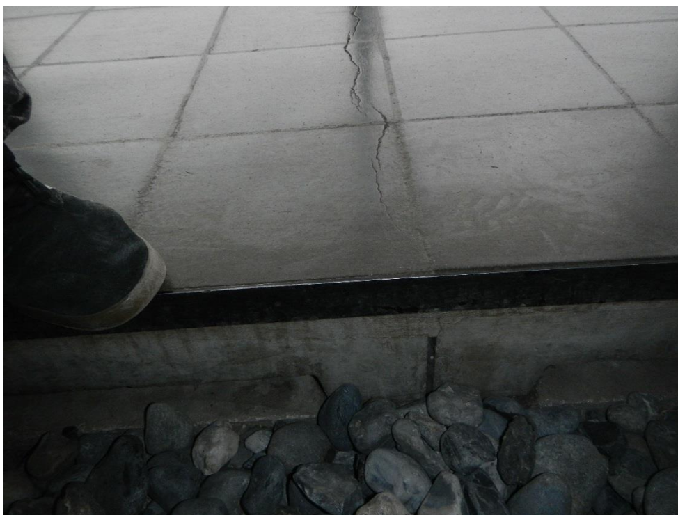
Foto 7.1.5 – Revner i klinker i forbindelse med betonelementer udlagt på gangbro. Under betonelement ses luftsluse for udsugningsanlæg.
