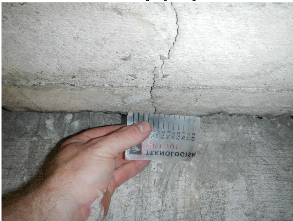
Foto 7.1.6 – Tværgående revne i underside af gangbro.
