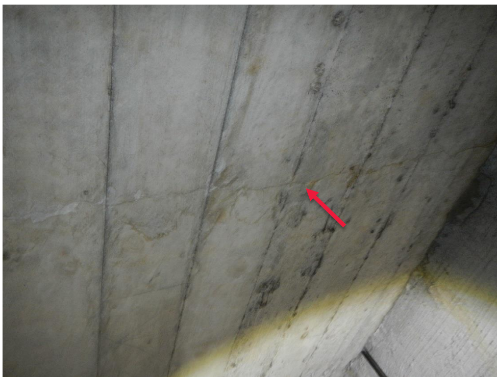
Foto 7.1.7 – Revne i underside af gangbro
