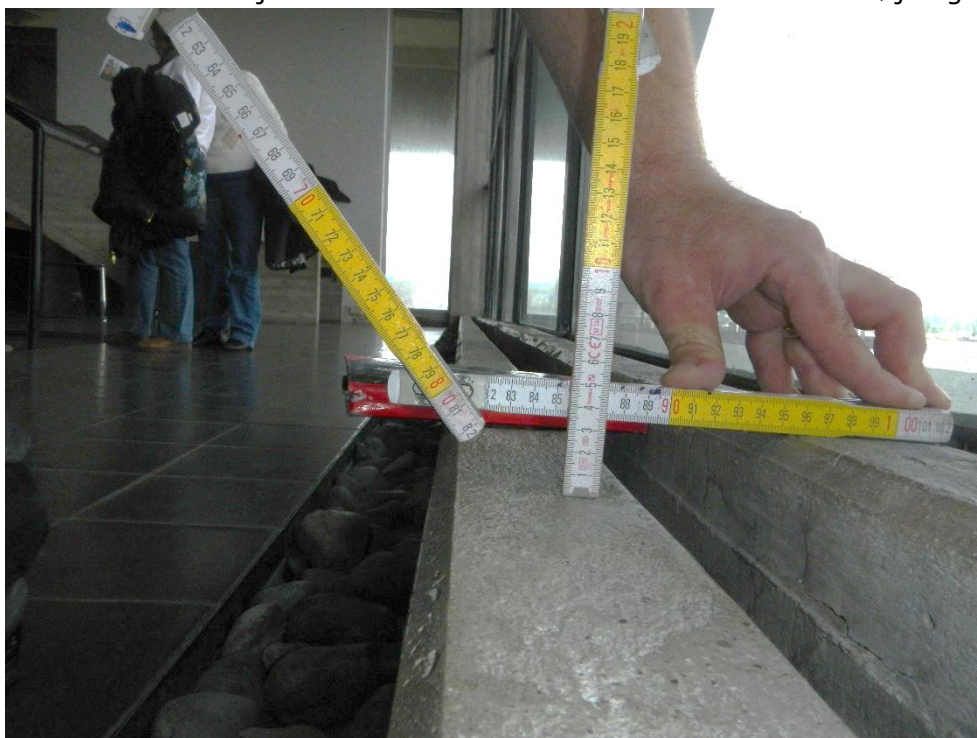
Foto 7.1.2 – Nedbøjning af kantbjælke
