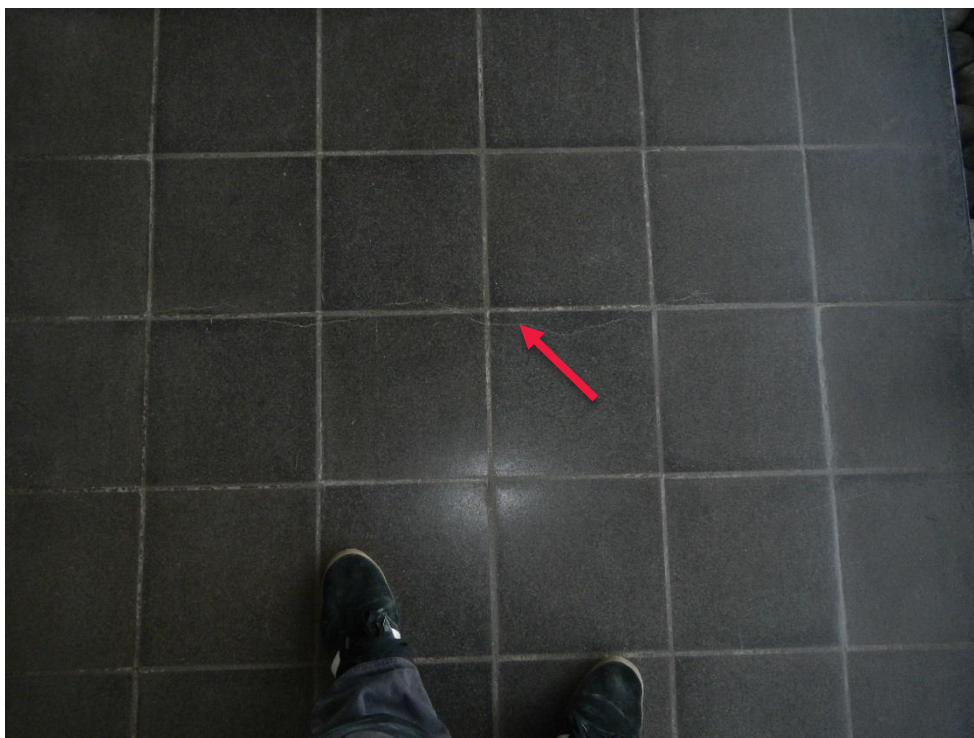
Foto 7.1.4 – Revnedannelse i klinkebelægning på gangbro.
