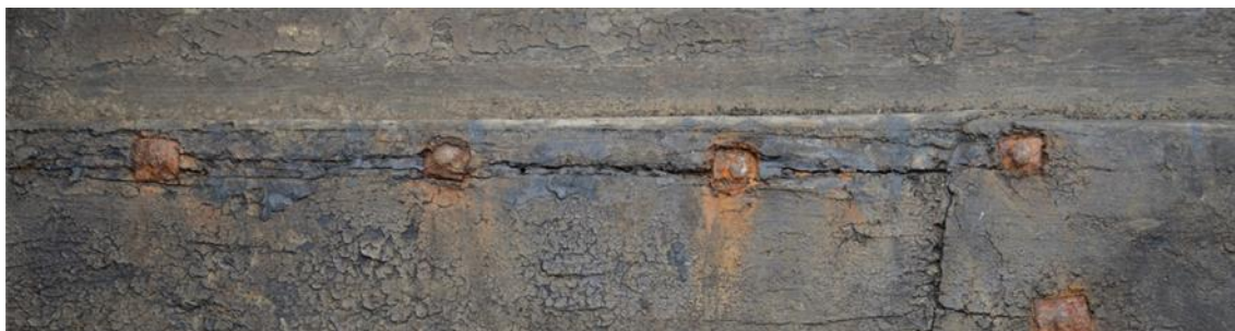
Bordene flækker i landingerne i takt med, at jernnaglerne udvider sig, når de korroderer.
